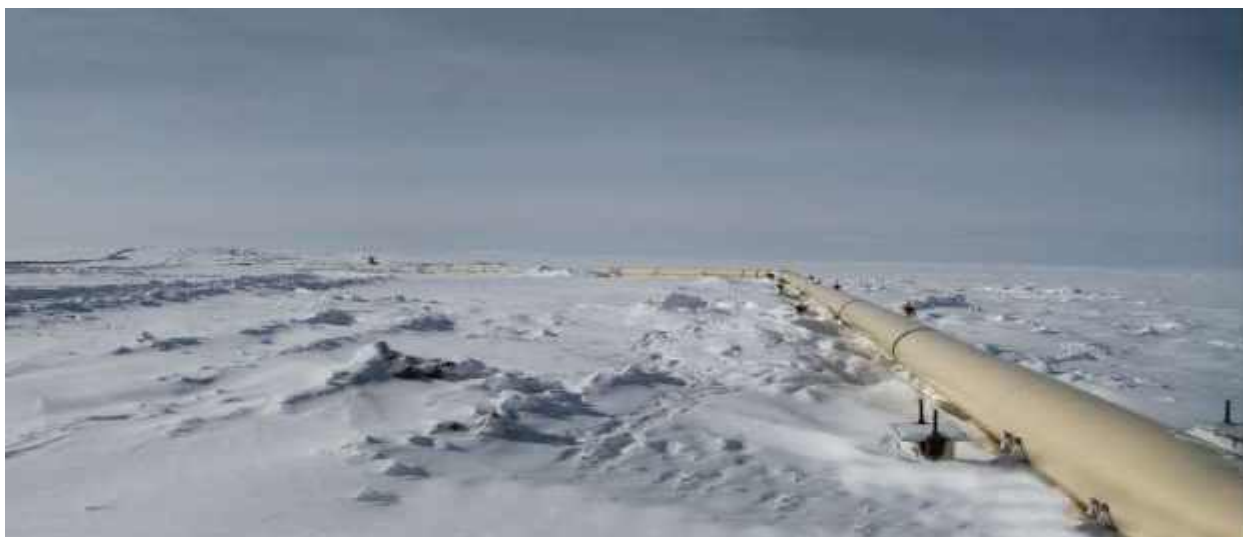
Рисунок 19 - Межпромысловый газопровод «Пелятка – Северо-Соленинское»
